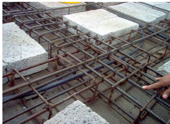
b) Acero colocado no cumple con diámetro mínimo.
