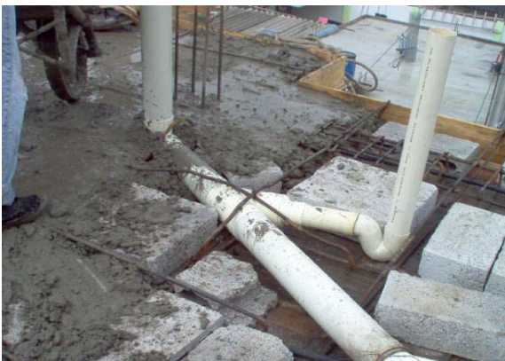
a) Mala distribución de tubería.
